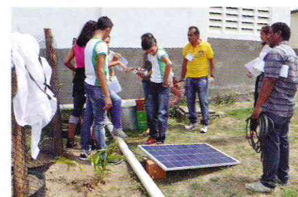
Oficina de energia solar com o técnico Fco. José Firmino
